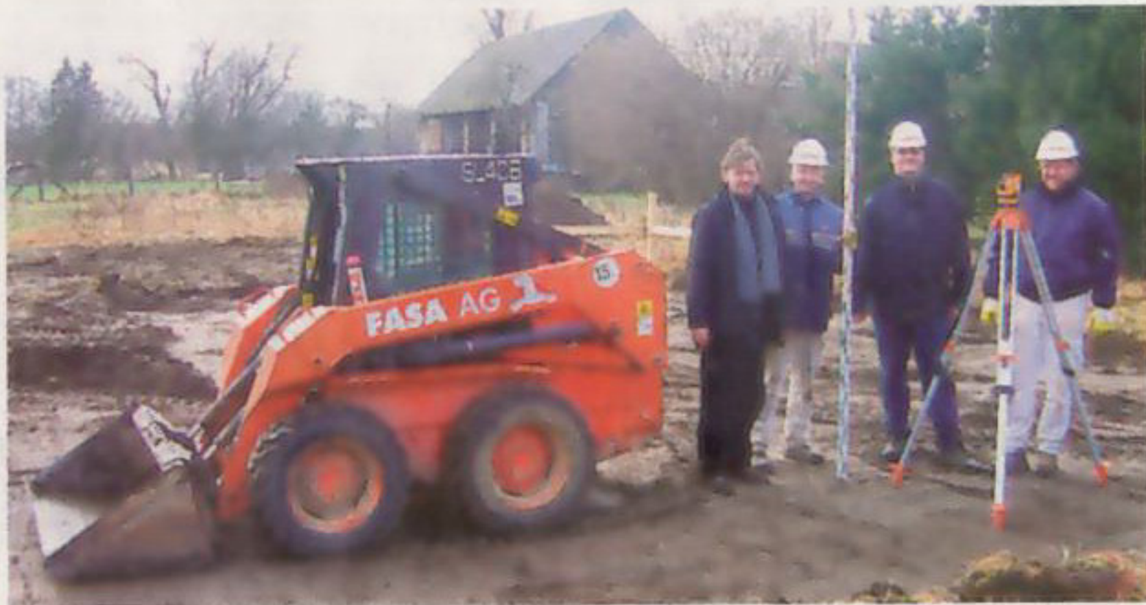
Die Erschließung des Grundstücks für das erste Solarhaus in Drebkau ist in Angriff genommen worden.
